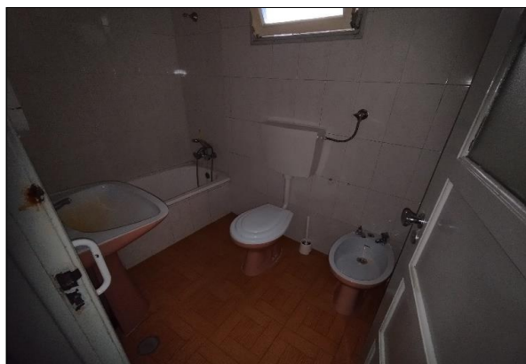
Nº 1 - R/C - Instalação sanitária
